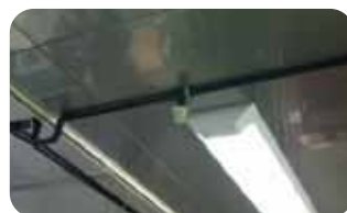
剥き出し配管例
